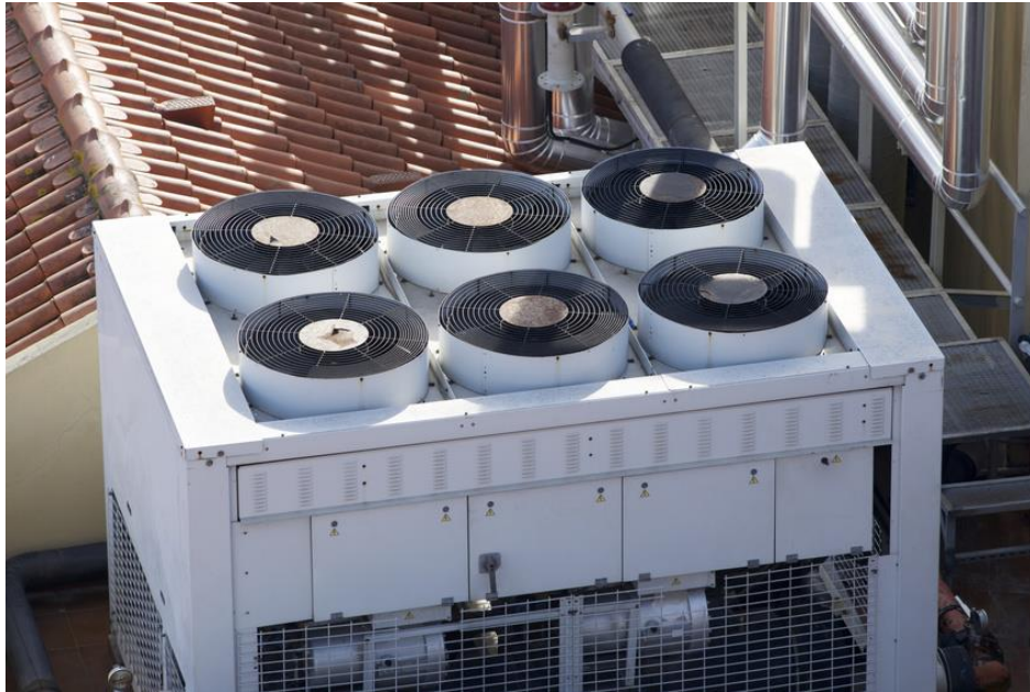
Abb.: Rückkühlturm einer zentralen Klimaanlage auf einem Dach
